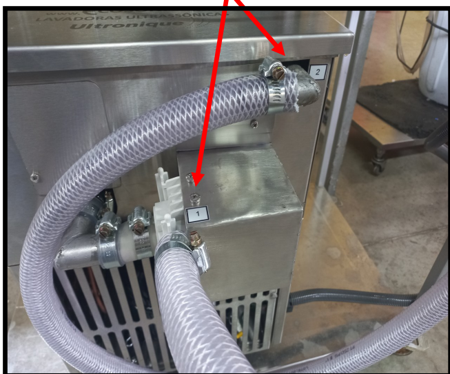
Conexões das mangueiras
