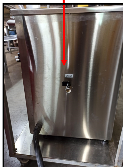
Válvula de drenagem manual
